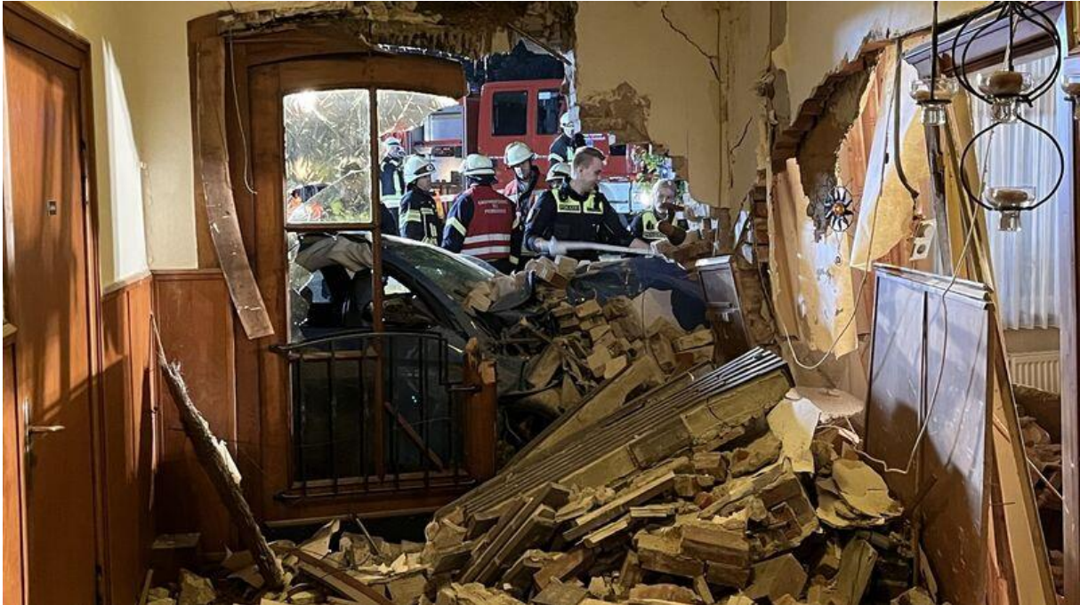
Blick durch die Tür in Richtung Straße: Das Gasthaus wurde durch den Aufprall des Pkw stark beschädigt. Foto: Vassel
