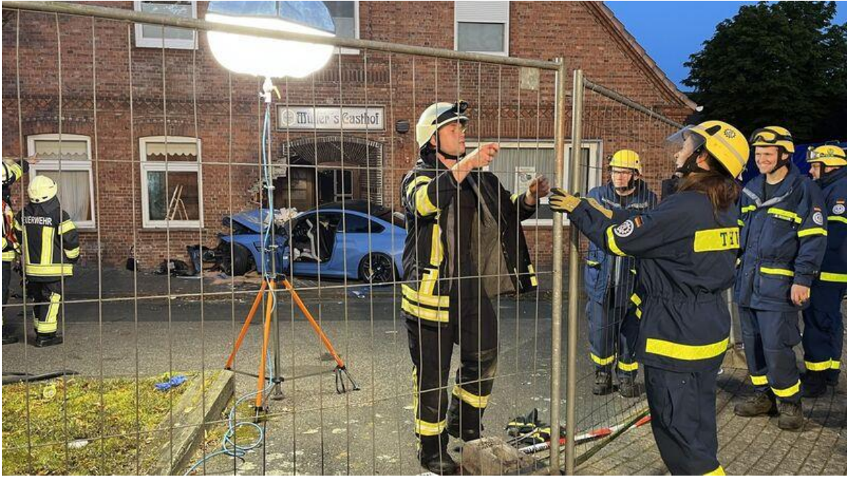
Feuerwehr und THW sichern das erheblich beschädigte Gebäude. Foto: Vasel
